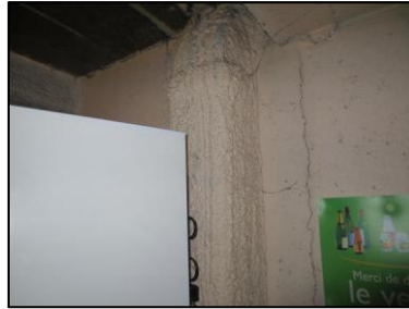
Photo N° 938 AMIANTE CIMENT -- LOCAL VO -1 Gainés & coffres verticaux Ventilation haute (Fibres- ciment)
