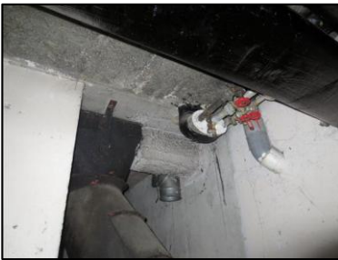
Photo N° 940 AMIANTE CIMENT -- LOCAL VO -1 Gainés & coffres horizontaux Coude de ventilation haute (Fibres-ciment)
